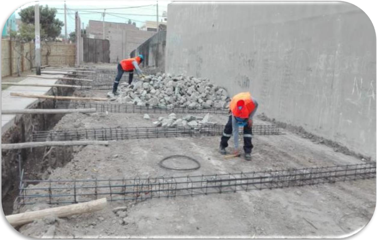
FOTO N°05. PODEMOS APRECIAR LA EXCAVACION DE ZANJA DEL CIMENTO CORRIDO Y ARMADO DE COLUMNAS CON PIEDRA GRANDE PARA LA CIMENTACION
