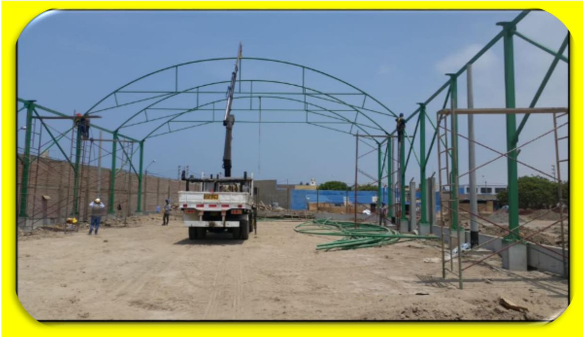
FOTO N°13. IZADO Y COLOCADO DE ESTRUCTURA METALICA CURVA PARA TECHO EN CAMPO DE GRAS SINTENTICO.
