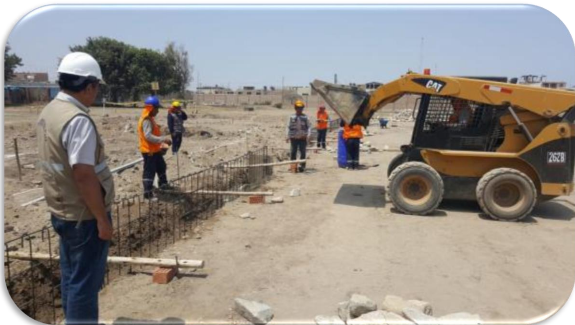
FOTO N°12. SE PUEDE OBSERVAR AL ING. SUPERVISOR VERIFICANDO EL VACIADO DE CONCRETO EN CIMIENTO CORRIDO PARA EL CERCO OLIMPICO.
