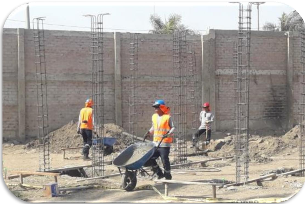
FOTO N° 10. SE PUEDE OBSERVAR EL VACIADO DE CONCRETO DE LAS ZAPATAS EN LAS OFICINAS ADMINISTRATIVAS.
